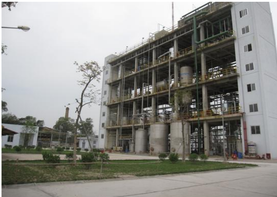
Nhà máy sản xuất ô xy già (H 2 O 2 )
