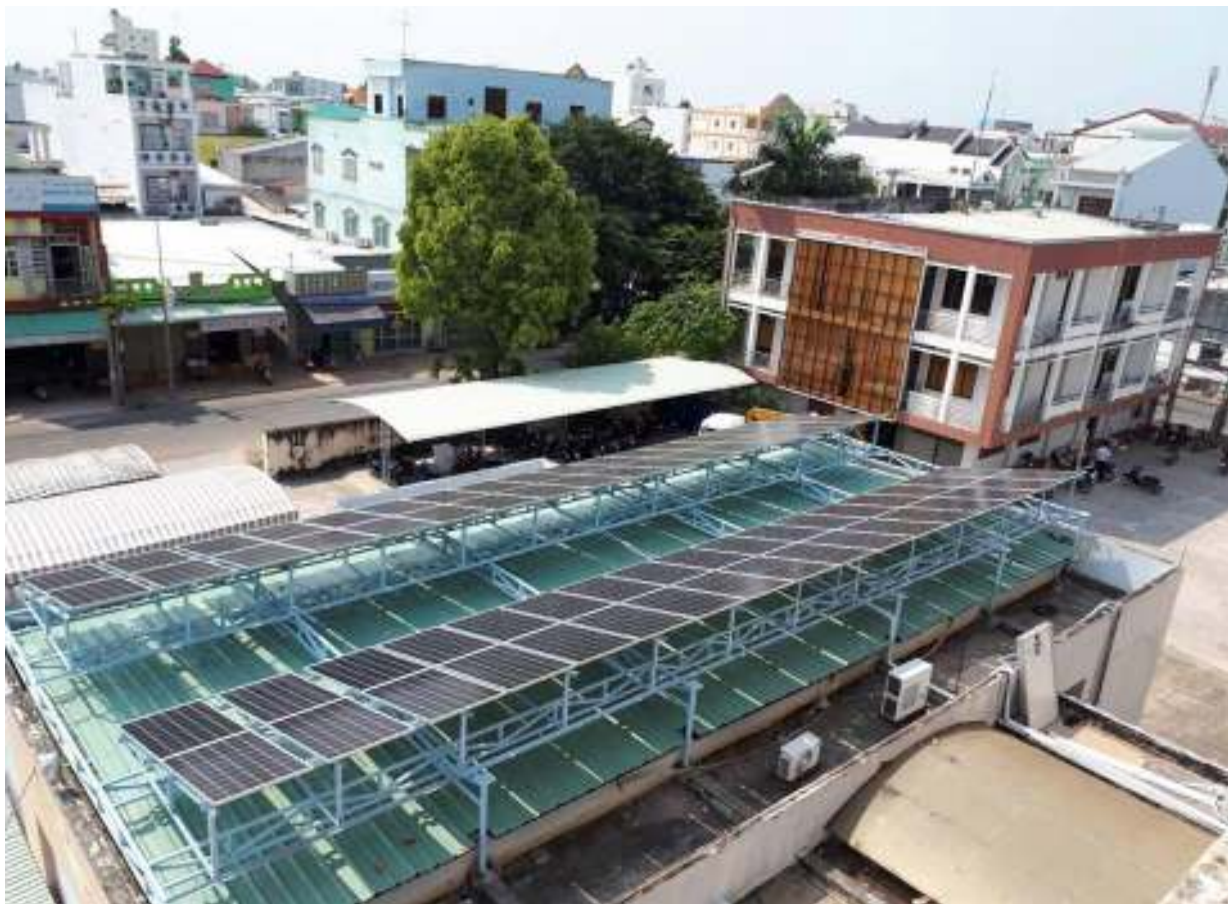
Hệ thống điện năng lượng mặt trời 98kWp tại Công ty Điện Lực Đồng Tháp
