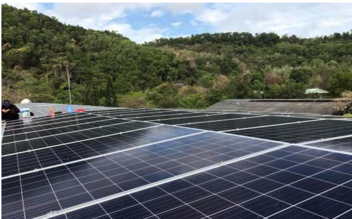
Sao Mai Solar hoàn thành lắp đặt hệ thống điện NLMT 10kWp tại Chùa Phật Quang, Bà Rịa - Vũng Tàu
