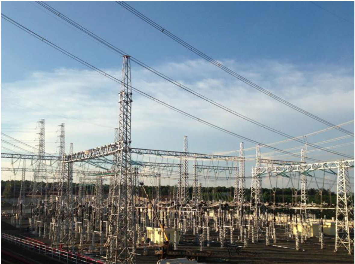
Trạm biến áp 500kV Pleiku
