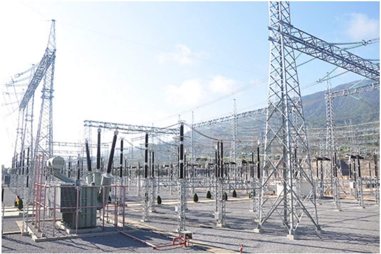
Trạm biến áp 500kV Sơn La
