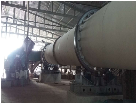
Hệ thống lò quay sấy sản
